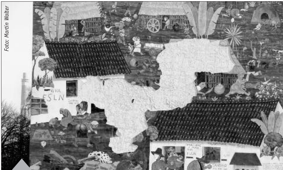
Dem Giebel-Wandbild an der Lichtenberger Brücke droht die Zerstörung. Große Stücke des Putzes sind schon von der Wand gefallen. Guter Rat und vor allem gute Hilfe sind teuer.
