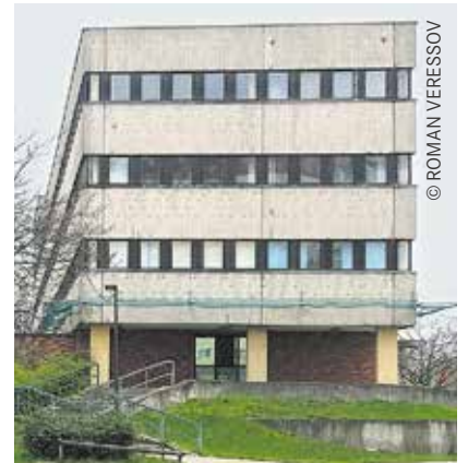
Polizeigebäude in der Pablo-Picasso-Straße: Nur durch ein grünes Netz sind PolizistInnen und BürgerInnen vor dem abfallenden Fassadenputz geschützt.
